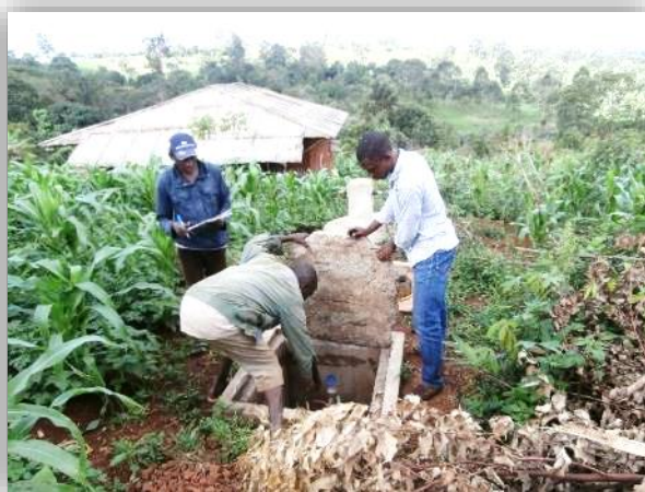
Prise de compteur sur une borne fontaine
